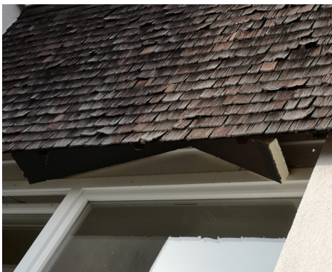
Der Zahn der Zeit nagt an der Dämmung der Fassade.
