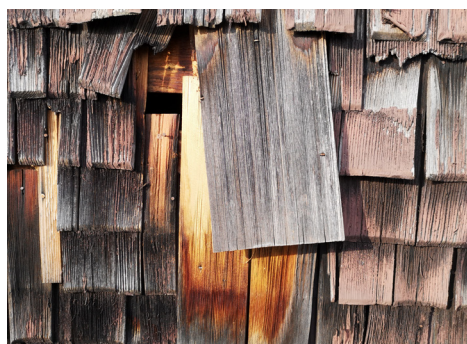
Die Schindeln der Außenfassade müssen dringend erneuert werden.
